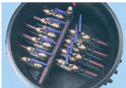
Kokoomakaivo 10 kalliolämpöputkelle. Säätöventtiili menoputkelle (punainen). Sulkuventtiili paluuputkelle (sininen).
